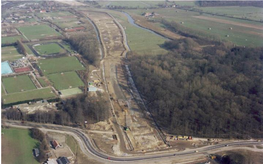
Zicht op de bouwwerkzaamheden bij het nieuwe tracé van de A27 ter hoogte van het landgoed Amelisweerd, rechts op de foto uit 1983. UA beeldbank, coll. Fotodienst GAU.
