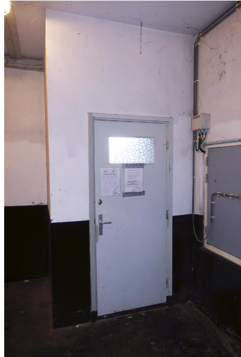
Op de onderste verdieping van het brugwachtershuis is in 1961 een toilet in de zuidwestelijke hoek gemaakt.
