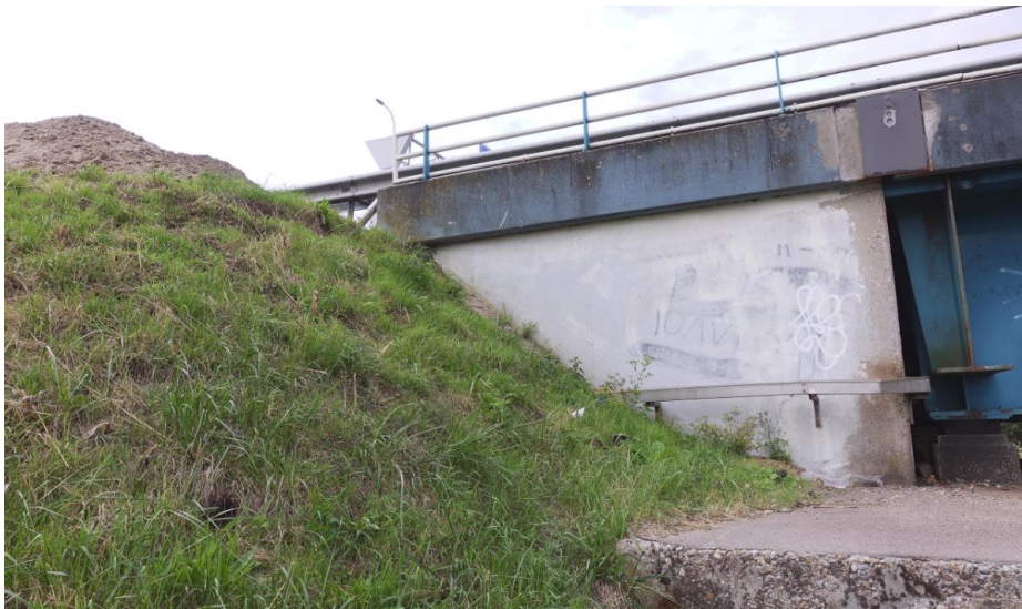
Zicht op de opbouw van het talud en het betonnen opgaande werk van het landhoofd.
