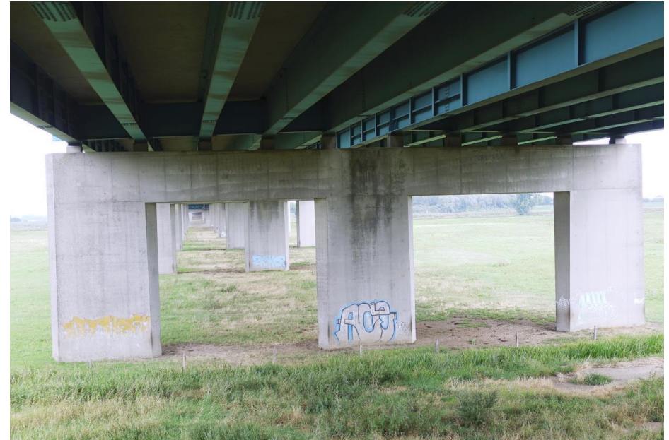
Zicht op de pijlers bij de aanbruggen. Deze zijn rechte van vorm en hebben een dwarsbalk aan de bovenzijde.
