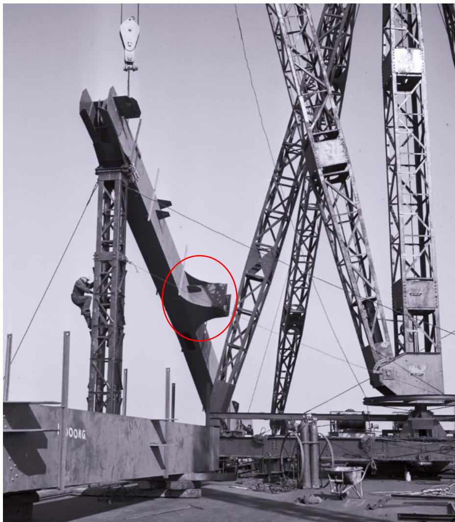
Zicht op de constructie van de bovenbouw van de boogbrug. De randen van de bogen zijn in delen aangebracht. In de rode cirkel is de aansluiting van de rand met het eindportaal zichtbaar. Ook de verschillende bevestigingen van de bovenwindverbanden zijn al aanwezig. RWS beeldbank, Afdeling Multimedia, nr. 24027-002.
