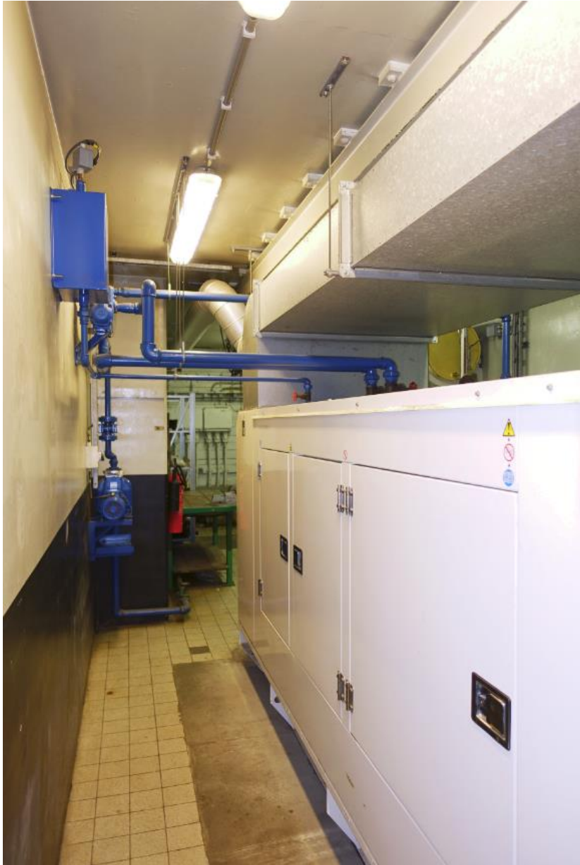
De machinekamer met tegelvloer gezien naar het zuiden.
