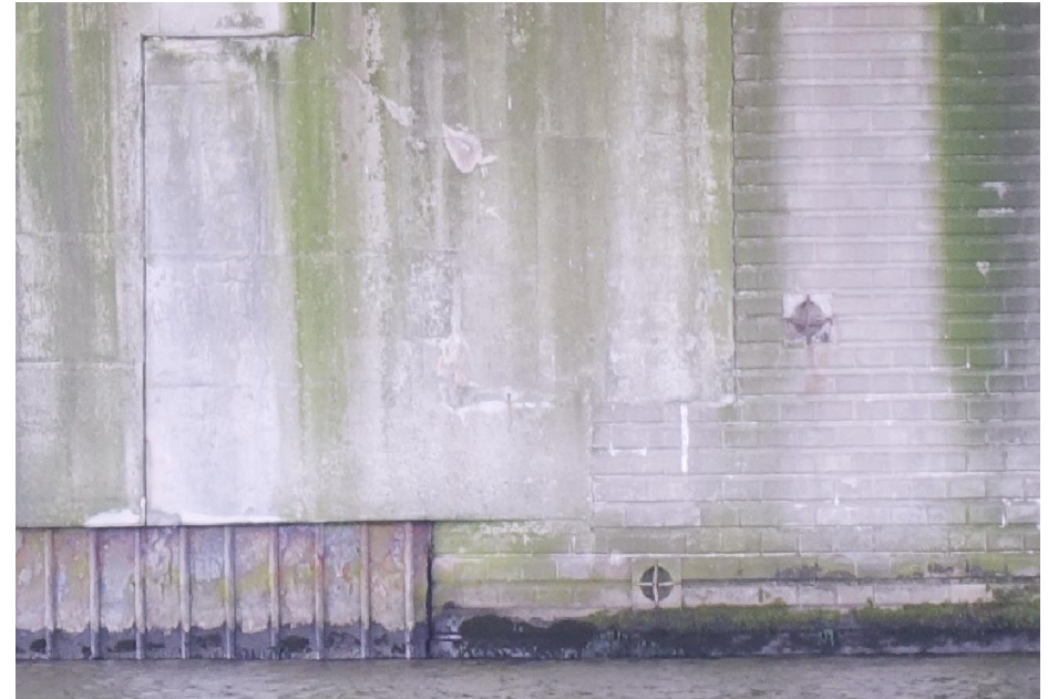
Detail van de natuursteen bekleding uit 1929-1931 en de betonnen verbreding met stalen damwand uit 1978 bij de zuidelijke rivier pijler.
