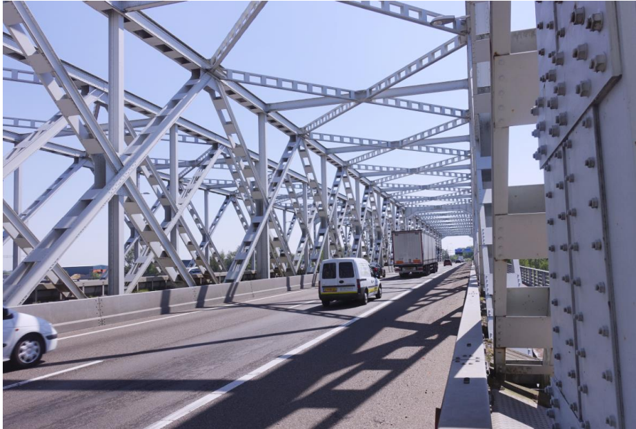
Zicht op de bovenwindverbanden bij de delen aan de westzijde van de brug.
