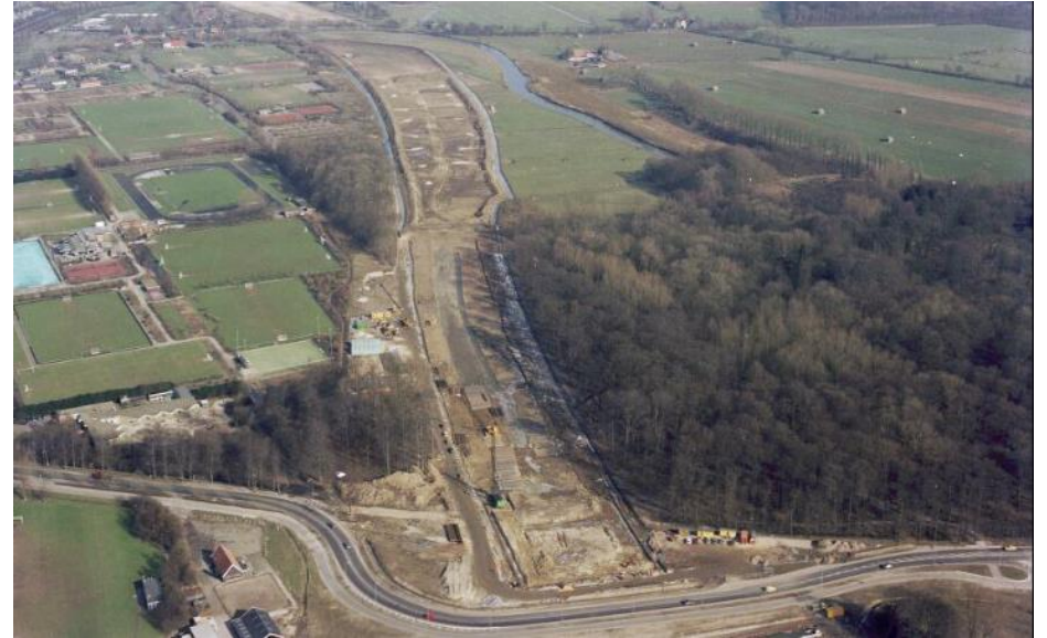
Zicht op de bouwwerkzaamheden bij het nieuwe tracé van de A27 ter hoogte van het landgoed Amelisweerd, rechts op de foto uit 1983. UA beeldbank, coll. Fotodienst GAU.
