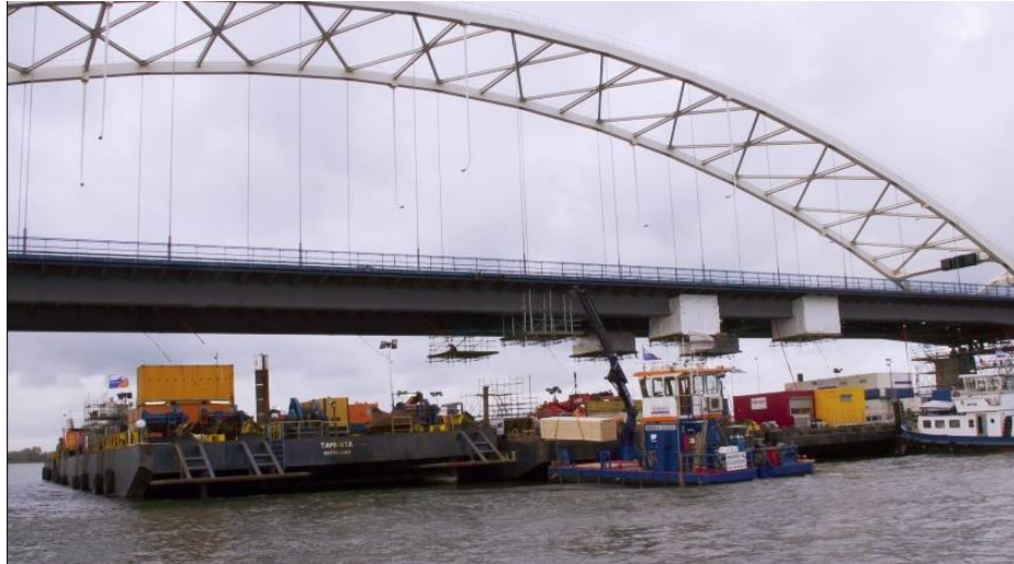
Reparatie van de hoofdliggers van de Merwededebrug in 2016. Rick den Besten, 'Merwededebrug volgende week weer open voor vrachtverkeer' op rickdenbesten.nl.
