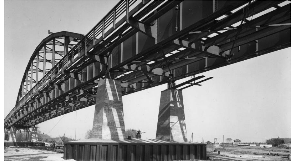
Een brug van het Amsterdam Rijnkanaal uit 1938. Ook deze brug heeft fietspaden aan de buitenkant, zoals gebruikelijk in die periode. Beeldbank RWS, nr. onbekend.
