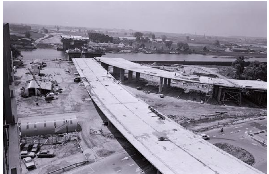
Zicht op de oprit naar de brug over de Nederrijn bij Arnhem tijdens de bouw in 1976, gebouwd in lichtbeton en volgens de vrije uitbouwmethode. RWS beeldbank, Afdeling Multimedia Rijkswaterstaat, nr. 24919-009.
