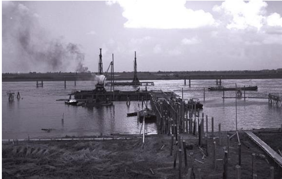
De bouw van de Merwedebrug tussen Gorinchem en Sleeuwijk is in 1958 begonnen. RWS beeldbank nr. 24020-015.
