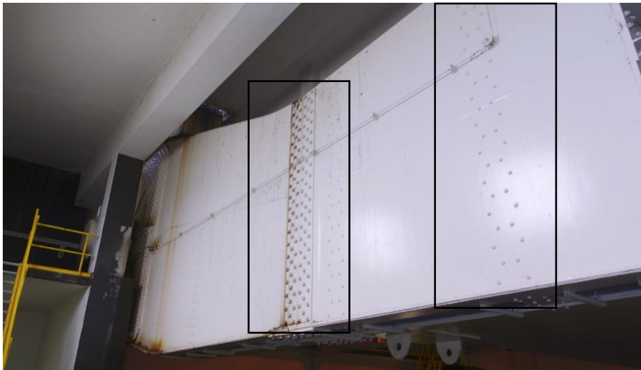
Zicht op de buitenzijde van het staartgedeelte bij de oostelijke ligger met de verstevigingen in de omlijning.
