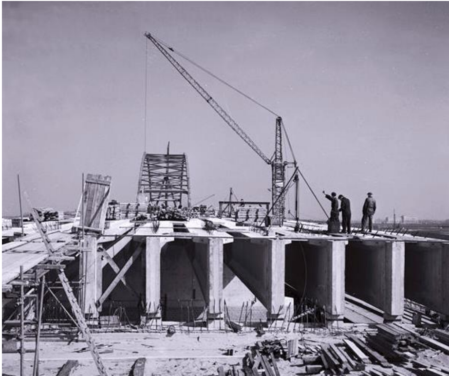
Zicht op de constructie van een van de aanbruggen. RWS beeldbank, Afdeling Multimedia, nr. 24032-064.
