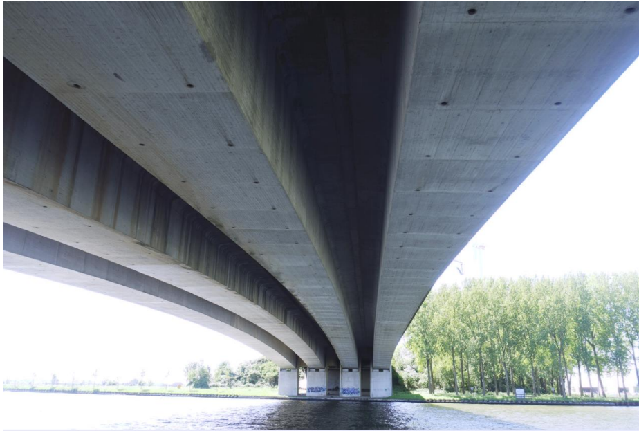
Zicht op de onderzijde van de kokers bij de hoofdoverspanning. De onderzijde van de moten heeft hier een rechte voeg.
