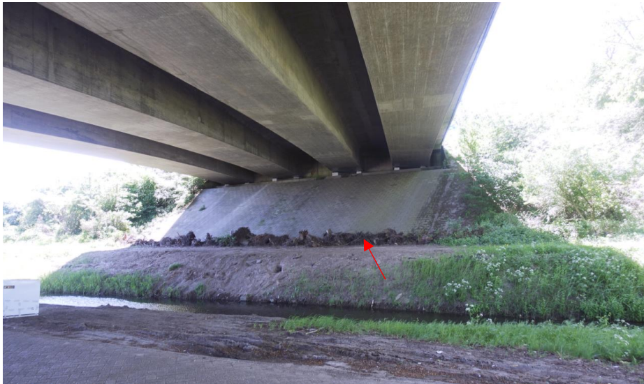
Zicht op het zuidelijke landhoofd met betontegels en stobbewal (rode pijl) onder de kokers.
