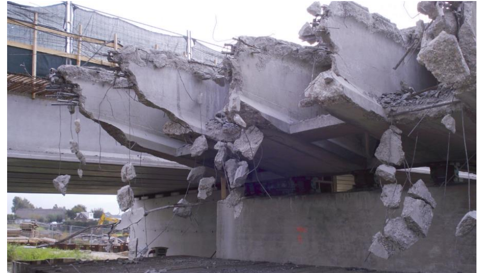
De Drechtbrug uit 1953 in Leimuiden bij de sloop in 2017 waarbij de opbouw van het voorgespannen beton goed zichtbaar is. Nebest.nl, fotoalbum: Nieuwe Drechtbrug in Leimuiden opengesteld.
