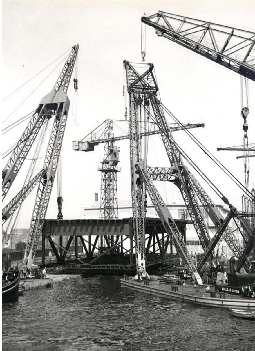
De plaatsing van het val in 1939 bij de brug over de Noord bij Alblasterdam geschiedde met veel drijvende kranen. RWS beeldbank, Afdeling Multimedia.
