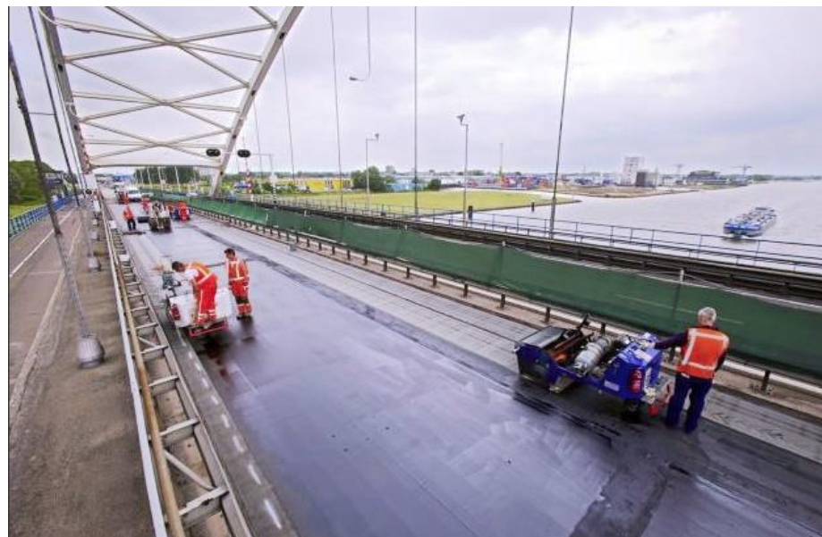
Het aanbrengen van een nieuwe asfalt laag op het rijdek van de A27. BN de Stem, 'Groot onderhoud snelweg 27' op 03-08-2012. afb: Johan Wouters/het fotoburo.
