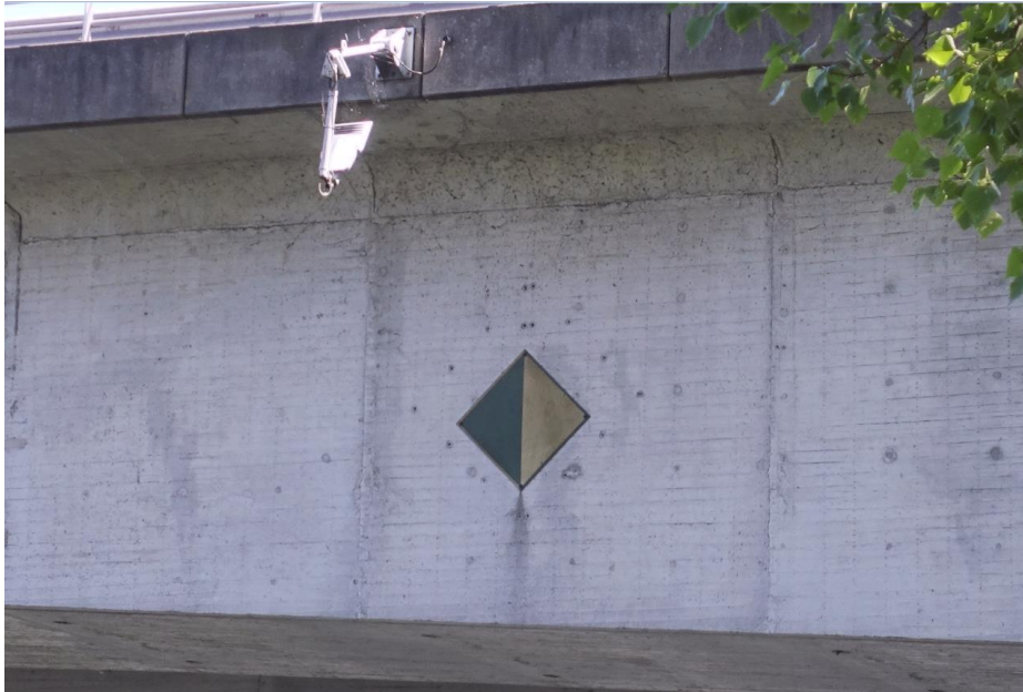
Ter hoogte van het signaalbord tegen de zijwand van de buitenste koker zijn veel gaten in het betonwerk zichtbaar.
