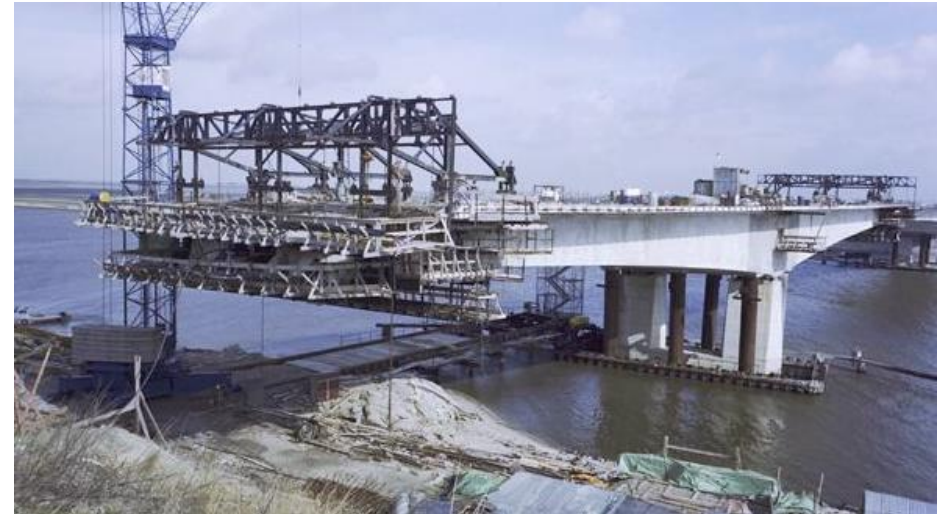
Bouw van de Stichtse Brug bij de oversteek naar Flevoland in 1982. RWS beeldbank nr. 25338-016.
