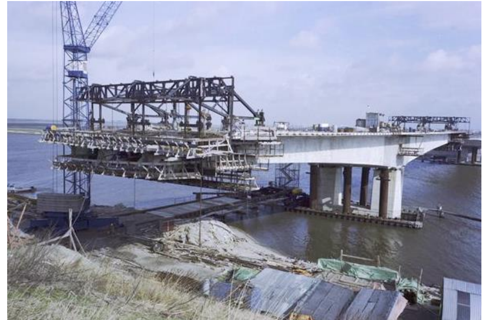
Bouw van de Stichtse Brug bij de oversteek naar Flevoland in 1982. RWS beeldbank nr. 25338-016.
