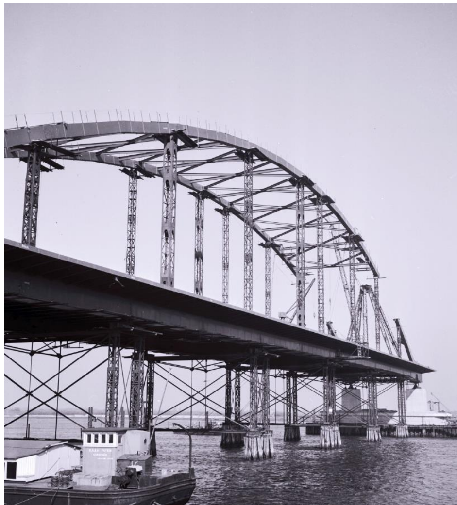
Zicht op de constructie van de boogbrug, die op de betonnen pijlers steunt en wordt gestut door een reeks van stalen noodpijlers. RWS beeldbank, Afdeling Multimedia, nr. 24027-005.
