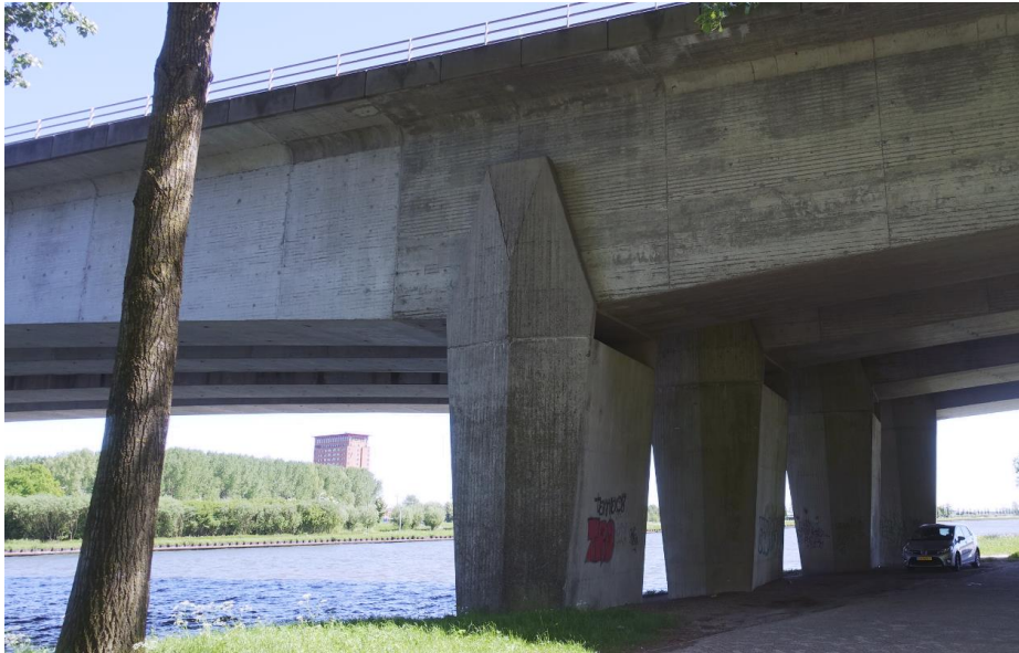
Zicht op de overgang van zijoverspanning naar hoofdoerspanning aan de zuidzijde van de oever. Het beton bij de zijoverspanning heeft een donkergrijze kleur, in tegenstelling tot het beton bij de hoofdoerspanning.
