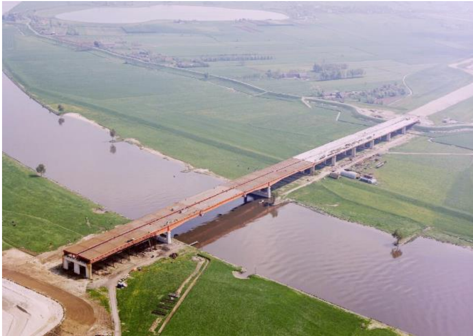
Luchtfoto van de in aanbouw zijnde Hagesteinsebrug in 1978 over de Lek in de Rijksweg 27 te Vianen, uit het noordwesten. UA beeldbank, coll. Delta-Phot Luchtfotografie, nr. 50561.
