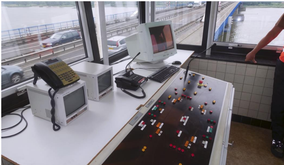
Zicht op het bedieningspaneel op het bovenste niveau in het brugwachtershuis.
