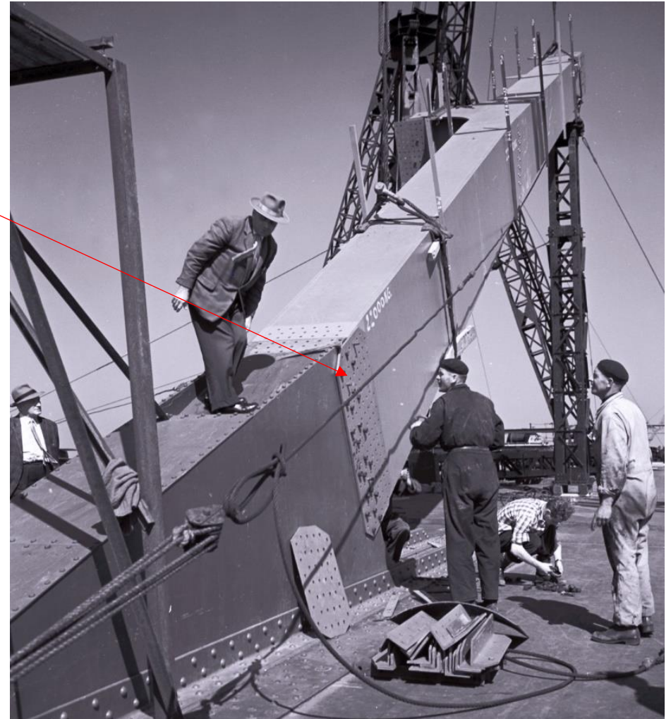
Zicht op de geklonken aansluiting van een van de bogen op de hoofdligger. Het donkere deel van de stalen aansluiting is al in de fabriek aangebracht waardoor de boog ter plekke in delen kon worden geconstrueerd. RWS beeldbank, Afdeling Multimedia, nr. 24025-010.
