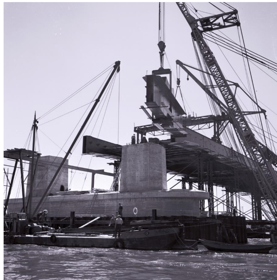
Zicht op de bouw van een van de rivierpijlers ter hoogte van een van de bogen. Deze pijlers zijn zwaarder uitgevoerd dan de pijlers van de aanbruggen. RWS beeldbank, Afdeling Multimedia, nr. 24024-001.
