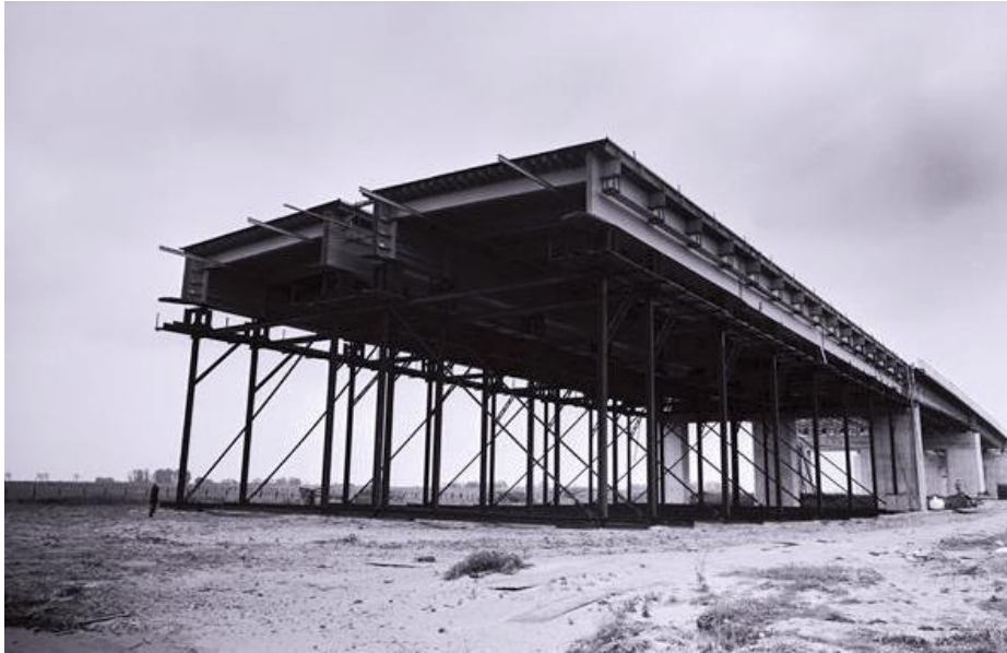
De bouw van de Hagesteinsebrug in 1977 met de zicht op de aanbrug. RWS beeldbank, Afdeling Multimedia Rijkswaterstaat, nr. 24160-023.
