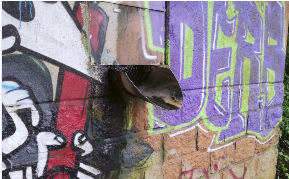
Aan de uiteinden van elke pijler bij de aanbruggen is een afgesloten goot gemaakt. De gootmond en de beplating van roestvrijstaal zijn recent aangebracht.
