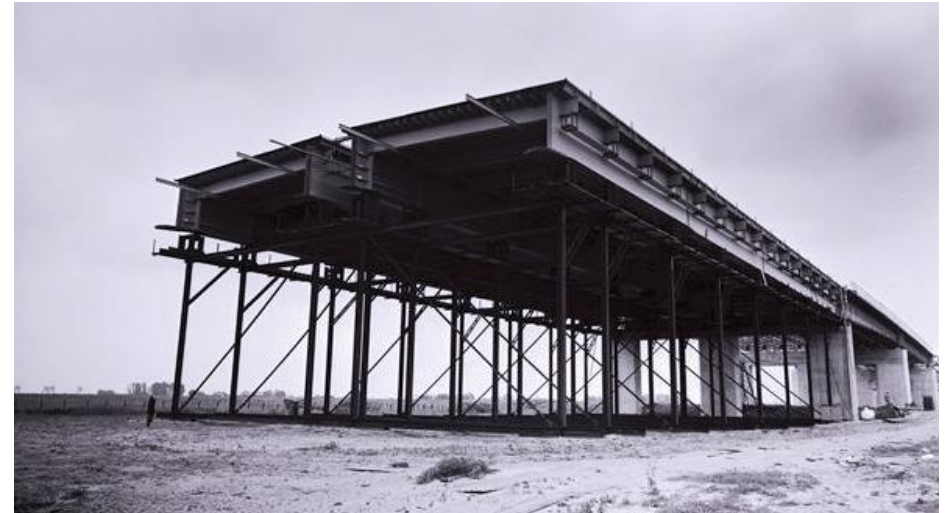
De bouw van de Hagesteinsebrug in 1977. RWS beeldbank, Afdeling Multimedia Rijkswaterstaat, nr. 24160-023.
