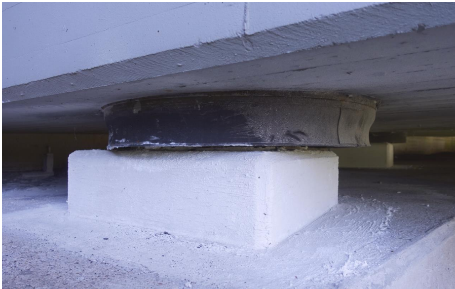
Detail van een van de opleggingen op het noordelijke landhoofd. Het rubberen schort dient ter bescherming van de teflon oplegging.
