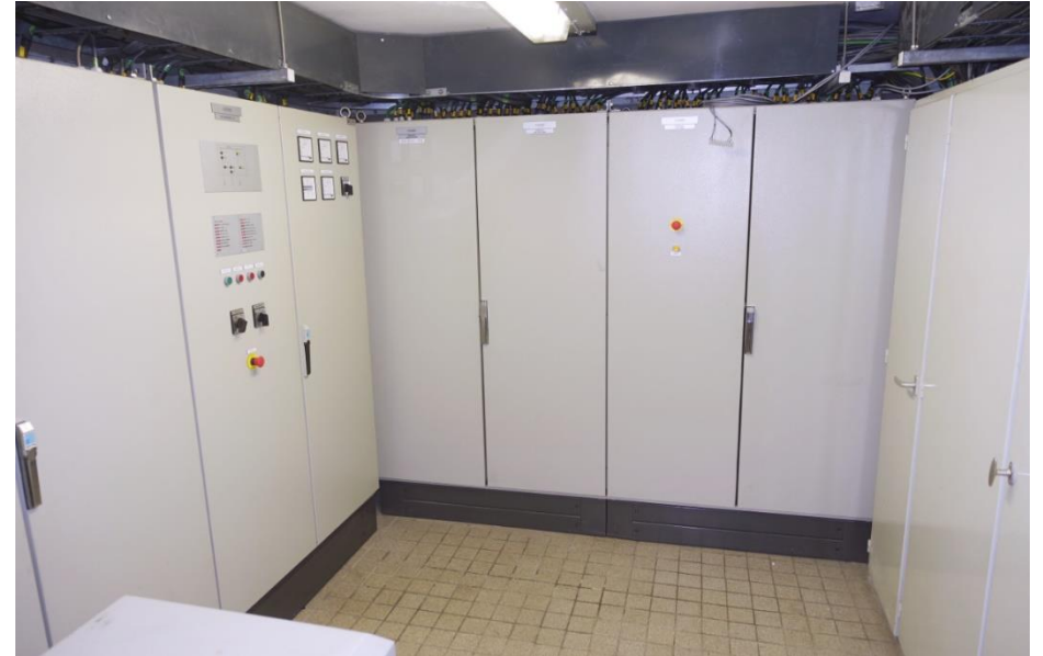
Zicht op de moderne technische ruimte in het westelijke deel van de basculepijler.
