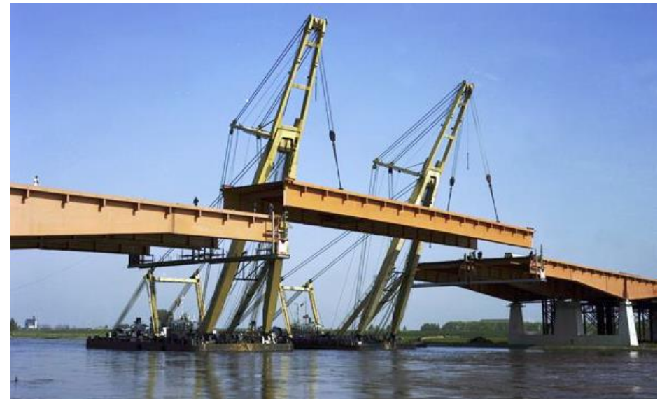
Het laatste deel van de overspanning van de Hagesteinsebrug wordt in 1978 ingevaren en geplaatst. RWS beeldbank, Afdeling Multimedia Rijkswaterstaat, nr. 24970-020.
