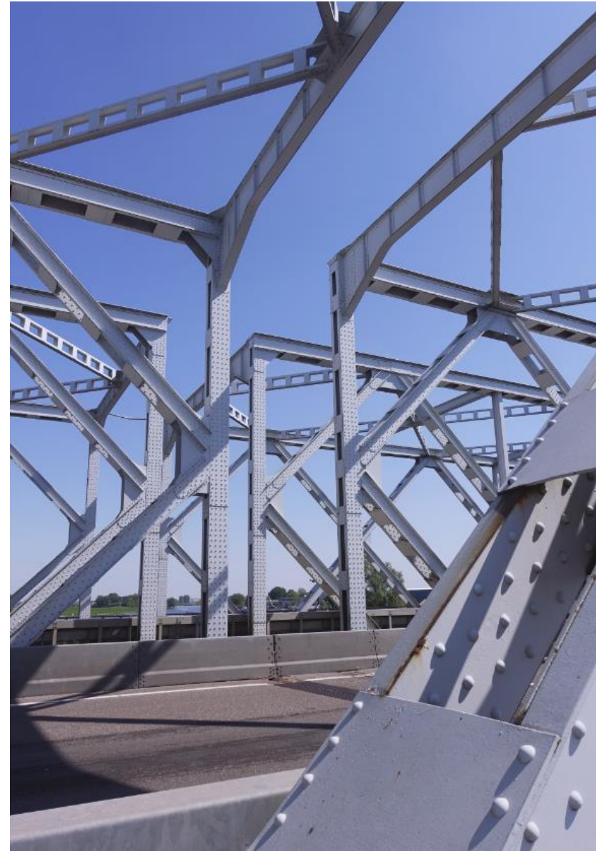
Het portaal bij de overgang tussen het middelste en zuidelijk deel heeft in 1978 geen verstevingen gekregen.
