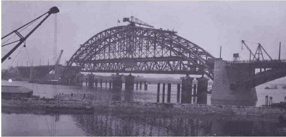
De bouw van de Waalbrug bij Nijmegen in 1935. RAN beeldbank nr. F47123.
