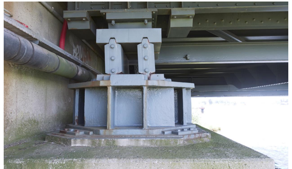
Detail van de rolopleggingen met onderzadel en stelplaat uit 1978 bij het noordelijke landhoofd.
