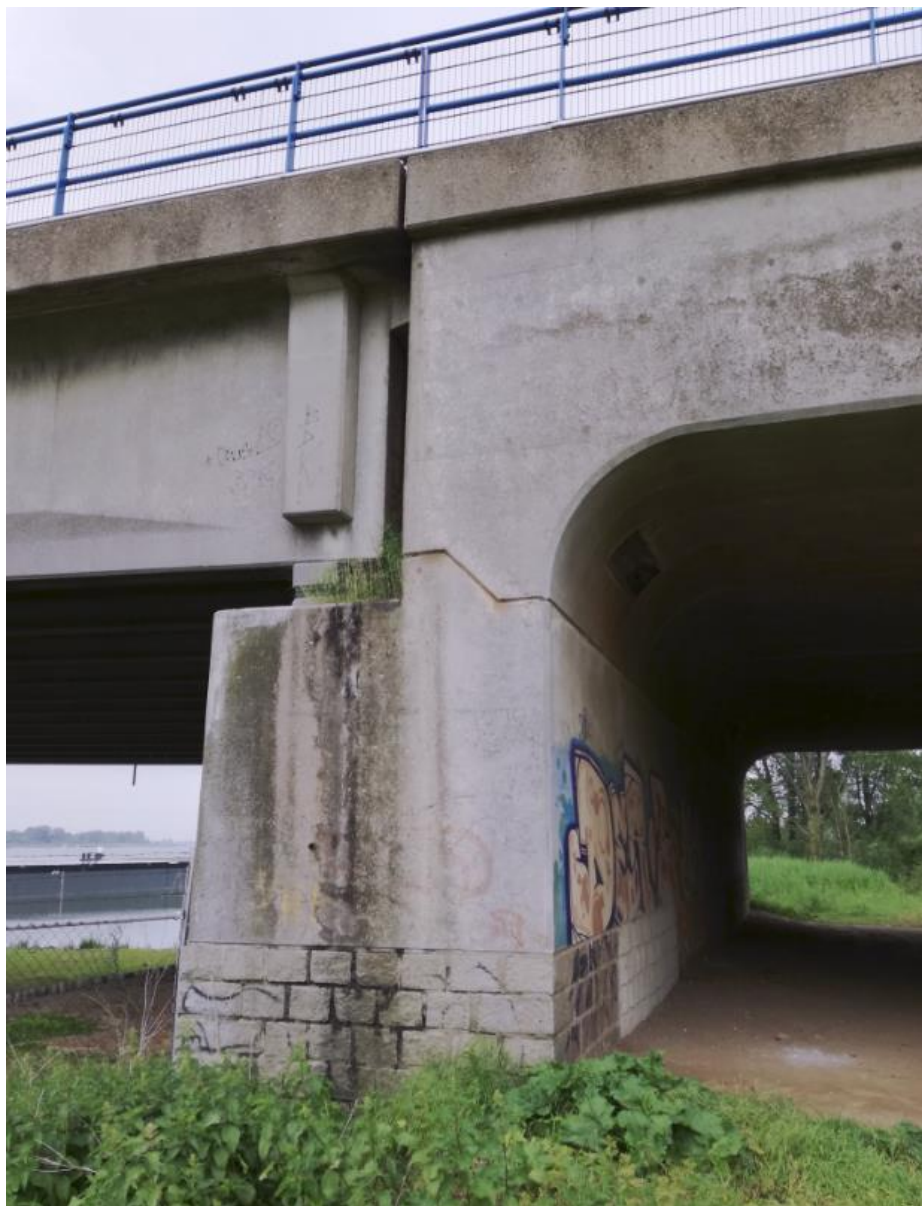
Detail van de aansluiting van de onderdoorgang aan de noordzijde met de aanbrug. De verbinding tussen onderdoorgang en pijler lijkt te zijn gelijmd.
