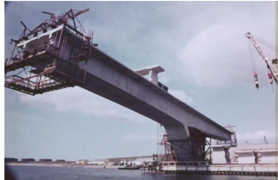
Zicht op de uit prefab elementen bestaande kokerliggerbrug over de Brielse Maas uit 1969. De elementen zijn met epoxylijm aan elkaar gelijmd. Uit: Over lijmen gesproken , promotiefilm provincie Zuid-Holland, 1967-1968.
