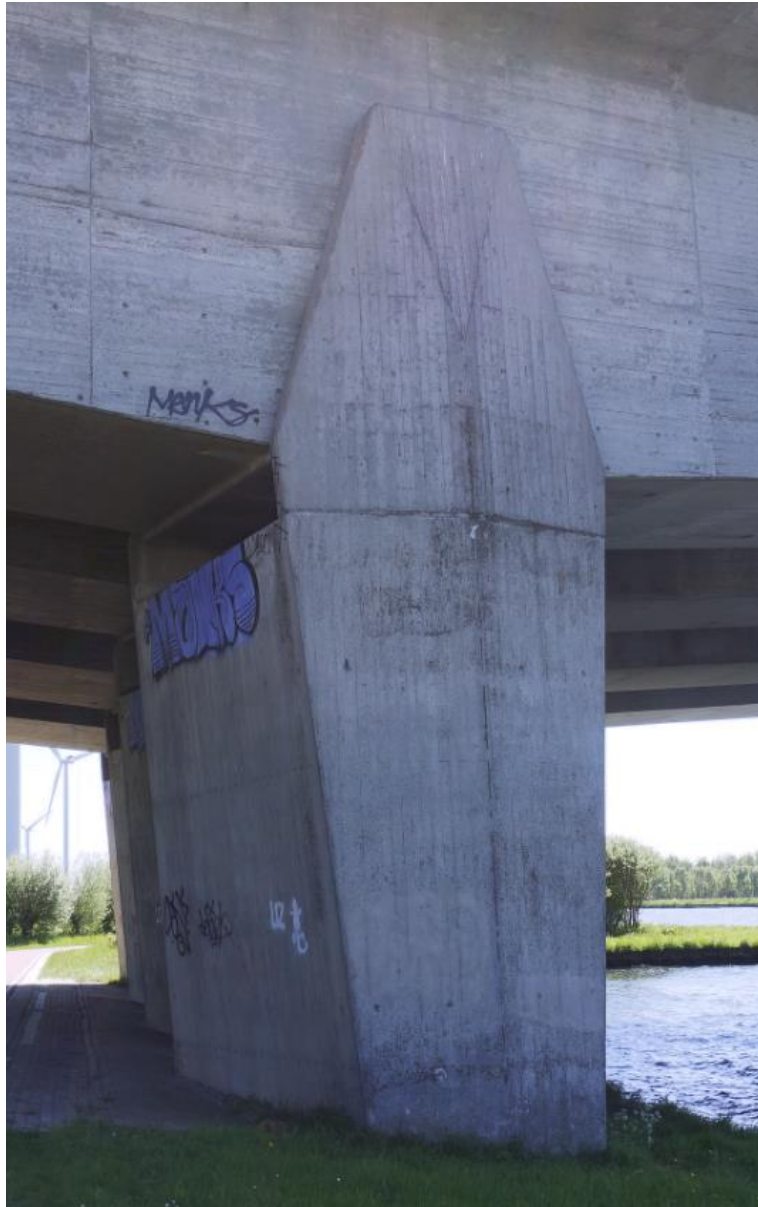
Zicht op de kopse kant van een van de pijlers op de noordoever, die zowel aan boven als onderzijde taps toeloopt en een afgeschuinde opbouw heeft.
