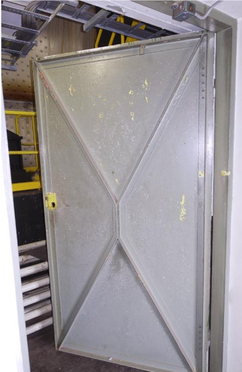
De ruimtes op de onderste drie verdiepingen in het brugwachtershuis worden afgesloten met de stalen deuren uit 1961.
