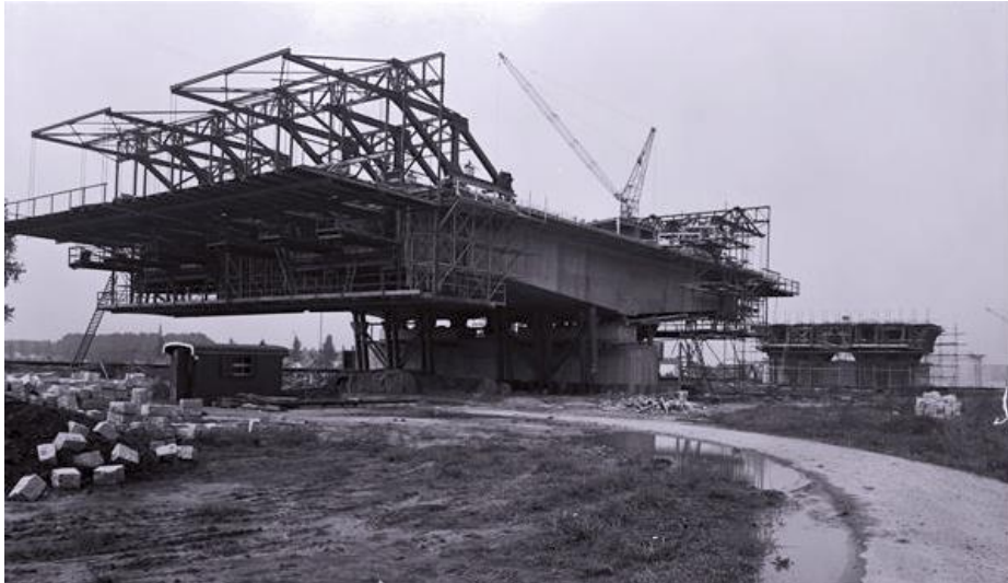
De bouw van de Maasbrug bij Wessem in 1964, die geheel uit gestort beton bestaat en via het principe van de vrije uitbouwmethode is geconstrueerd. RWS beeldbank, Afdeling Multimedia Rijkswaterstaat, nr. 24482-003.
