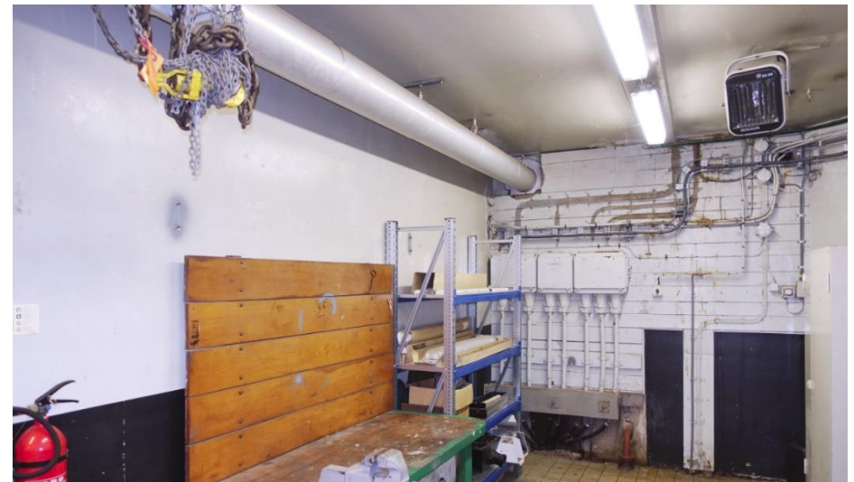
Zicht op de machinekamer gezien naar het noorden.
