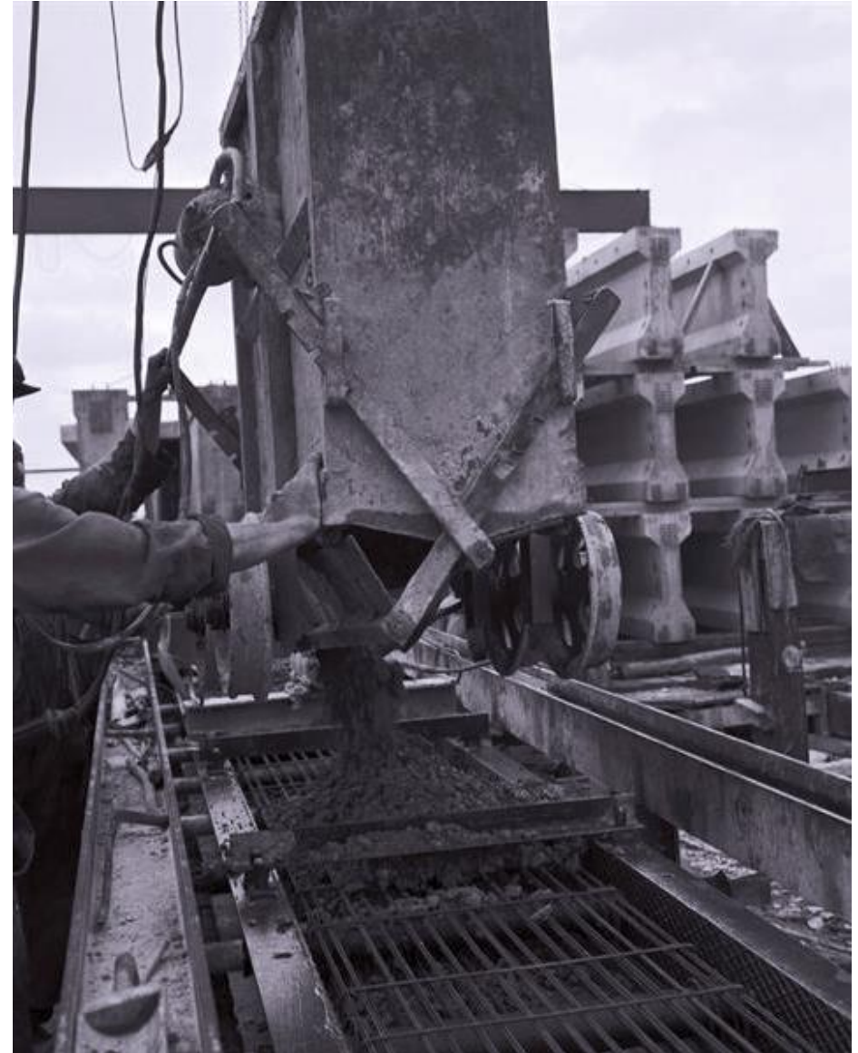
De liggers voor de aanbruggen werden ter plekke gestort en opgeslagen. RWS beeldbank, Afdeling Multimedia, nr. 24034-017.
