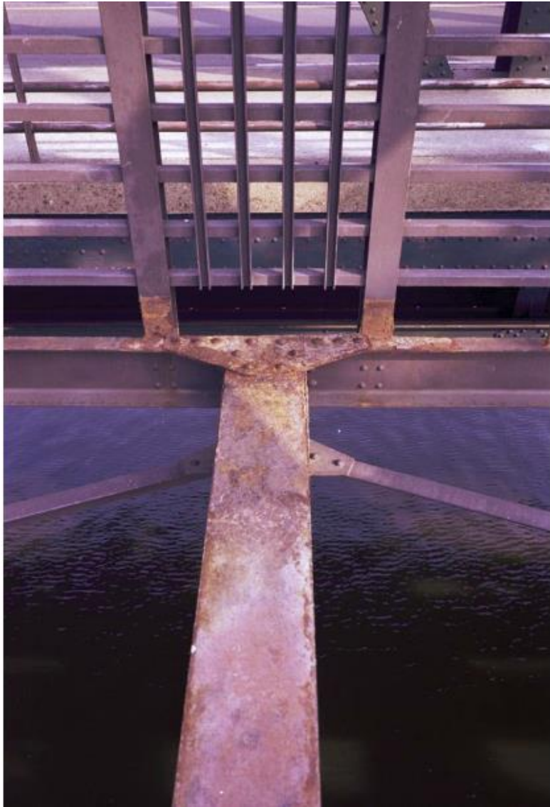
Zicht op de hoofdligger met onderwindverbanden bij de aansluiting met de leuning langs het fietspad van de voormalige Moerdijkbrug vóór conservatie. De opzet zou in zijn geheel terugkeren bij plaatsing van het brugdeel over de Bergsche Maas. RWS beeldbank nr. 23738-013.
