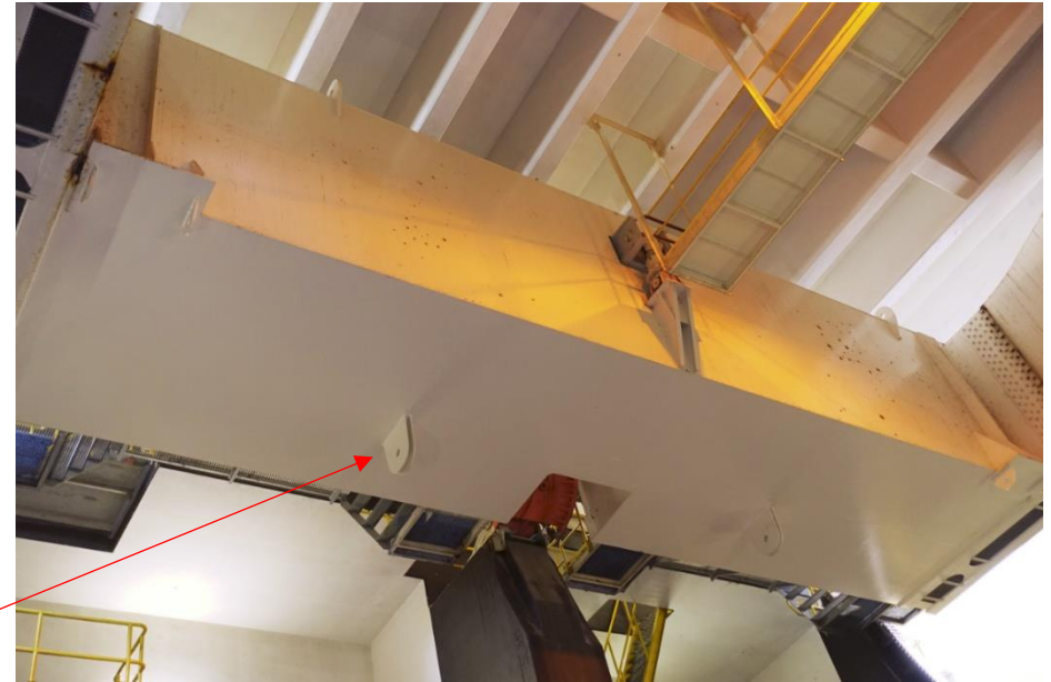
Zicht op het ballastblok met de stalen ogen die geborgen kunnen worden bij een open toestand van de brug.
