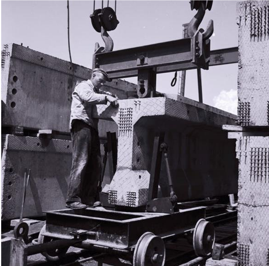
Zicht op de betonnen liggers die gebruikt zijn als langsliggers bij de aanbruggen. RWS beeldbank, Afdeling Multimedia, nr. 24034-008.
