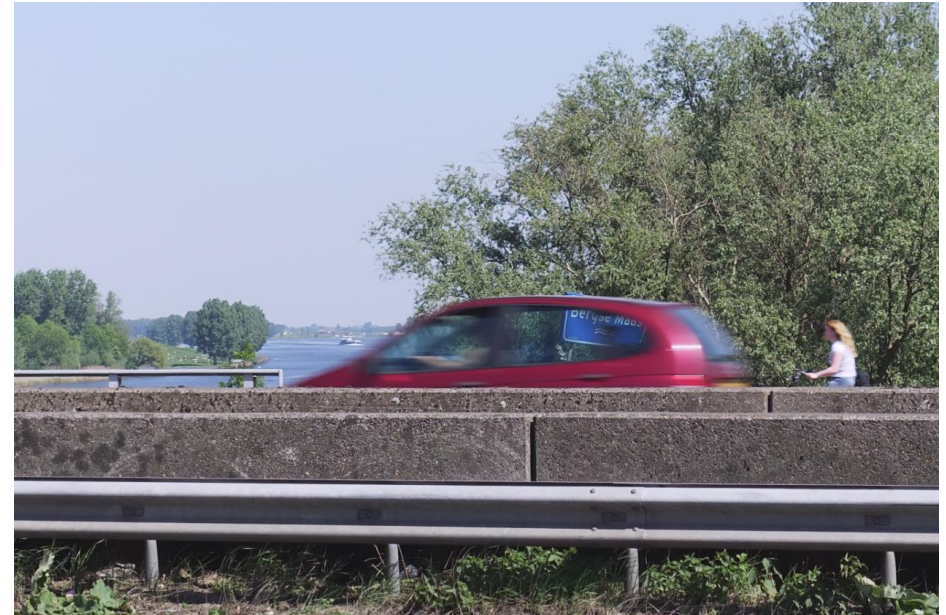
De strook voor langzaam verkeer is gelegen tussen een borstwering van damwand staal en betonnen afdekkingen, hier in detail zichtbaar aan de zuidzijde van de brug.
