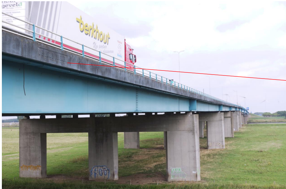
Zicht op de buitenzijde van de liggers van de zijoverspanningen waarbij consoles ter plaatse van de opleggingen zijn gemaakt.
