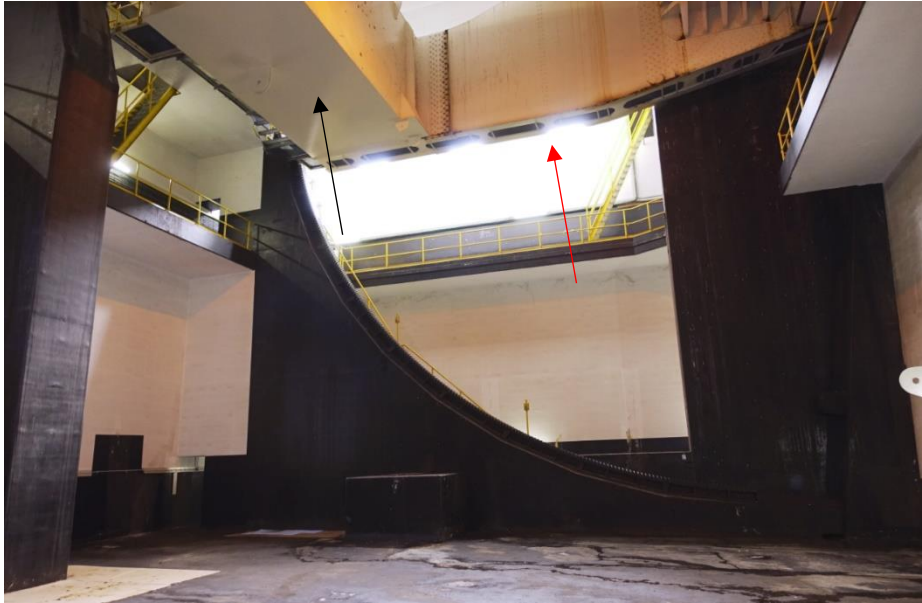
Zicht op de grote open ruimte met tandradsbaan. Bij de rode pijl is de hoofdlijger van het val zichtbaar en bij de zwarte pijl het ballastblok.
