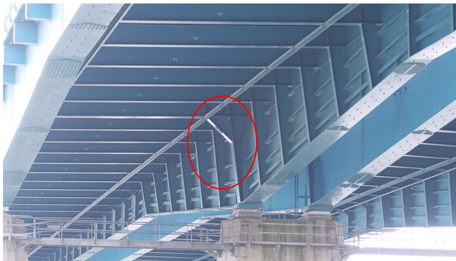
Zicht op de versterkingen aan de binnenzijde van de hoofdliggers. Ter hoogte van de pijler is een stalen console aangebracht (rode omlijning).
