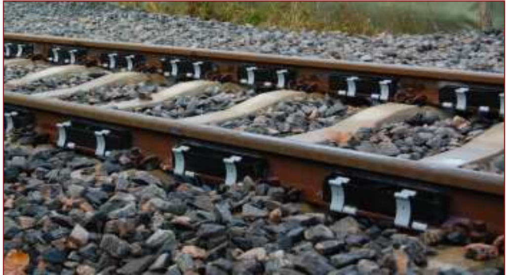
Figuur A-3 Een voorbeeld van de bronmaatregel raildempers. Dit zijn de zwarte rubberen blokken die in dit geval tegen de rails worden geklemd.
