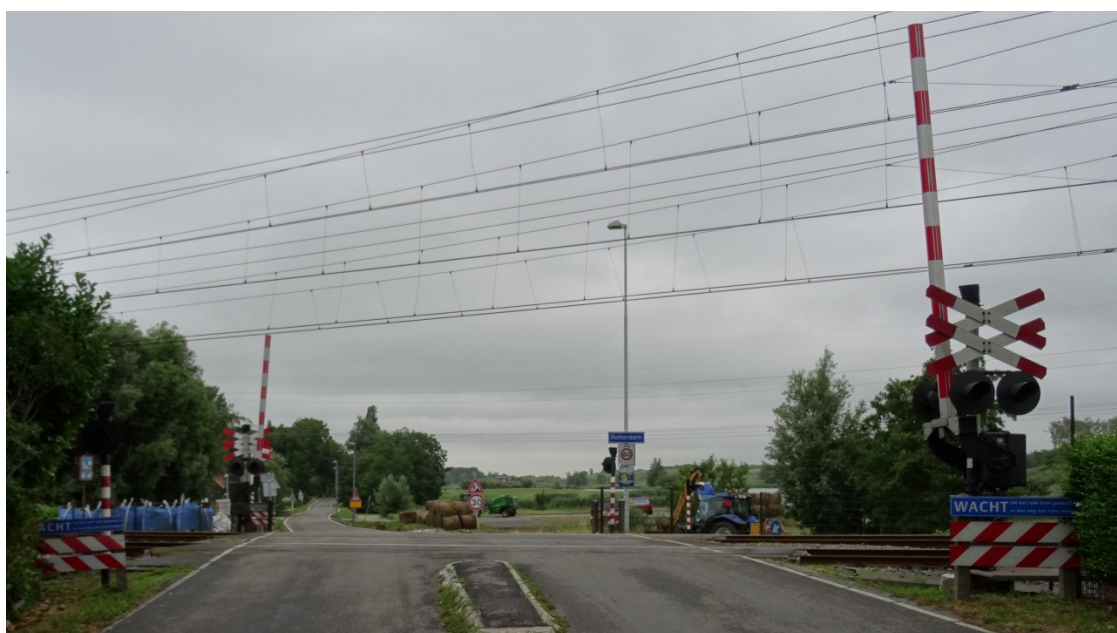
Figuur 8. Overzicht AHOB installatie met overwegbomen
