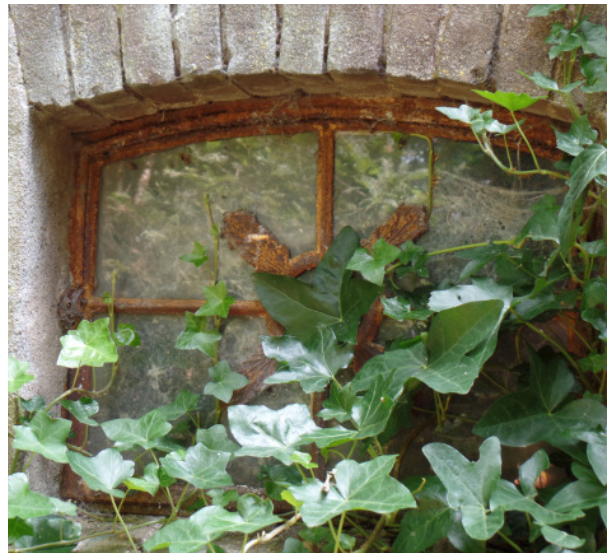
28. De stalen kozijnen van de schuur kennen een fraaie detaillering, maar vergen nodig onderhoud.
