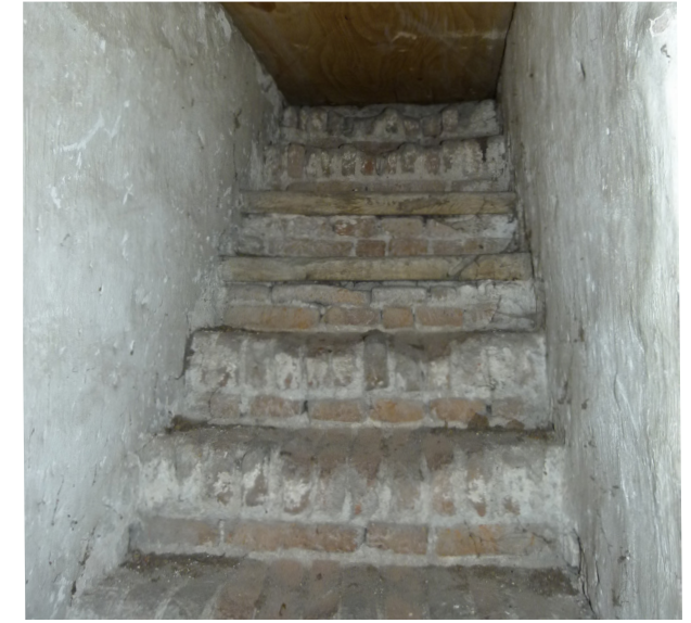
51. Het bovenste deel van de in de muur aangelegde trap naar de zolder is grotendeels van baksteen (RCE).
