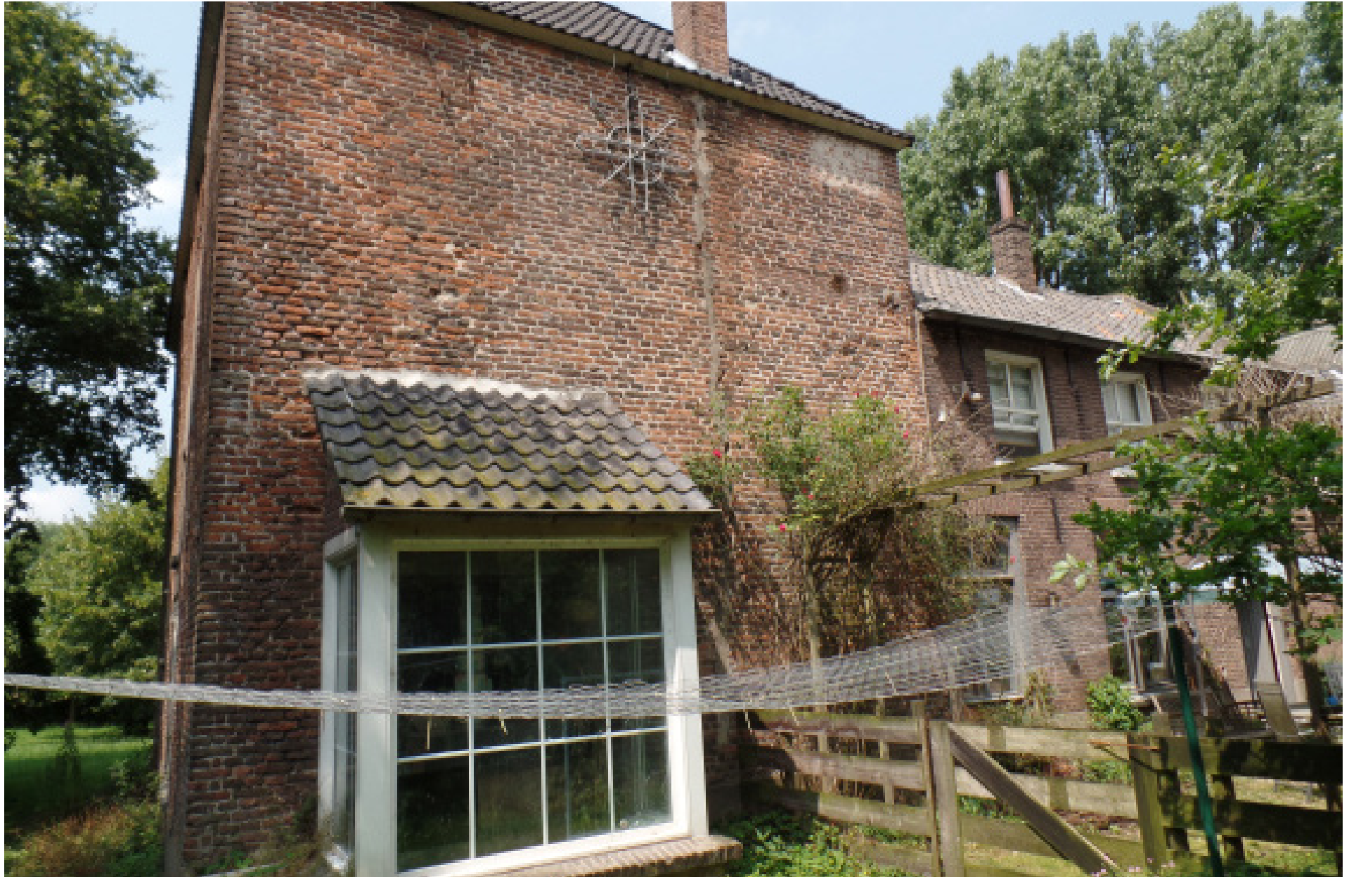
45. De zuidelijke gevel van het voormalige poortgebouw met rechts de tussenvleugel uit circa 1886.
