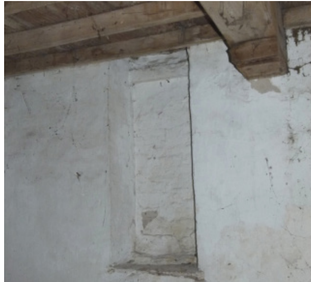
31. Een venster op de eerste verdieping van de vijftiende-eeuwse woonvleugel van het oudste deel, is dichtgezet met de bouw van de tussenvleugel omstreeks 1886.
