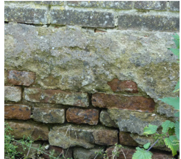
29. De schuur lijkt grotendeels gefundeerd op oudere, rode bakstenen.
