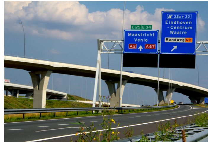
Voorbeeld van een fly-over in een weidse boog als 'poort' en een 'scenic route' biedend voor de weggebruiker bij het knooppunt De Hogt (Eindhoven).
