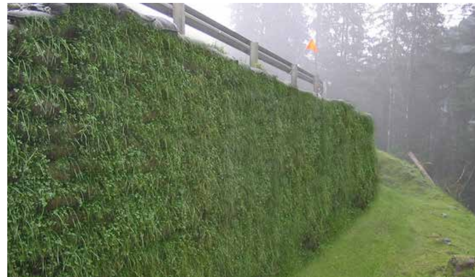
^ Referentie uitstraling van een grondkerend element. Zowel onbegroeid als begroeid een aantrekkelijke uitstraling.
